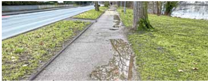
Der derzeitige gemeinsam genutzte Fuß- und Radweg am Moselufer weist Schäden auf, die im Zuge des Ausbaus beseitigt werden. Foto: Kai Friehe
