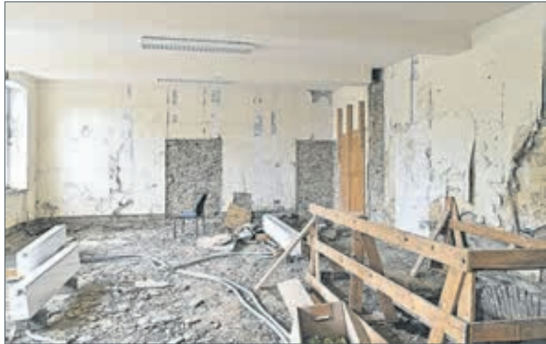
Weiter unten sieht es auch in diesem Gebäude noch wüst aus.
