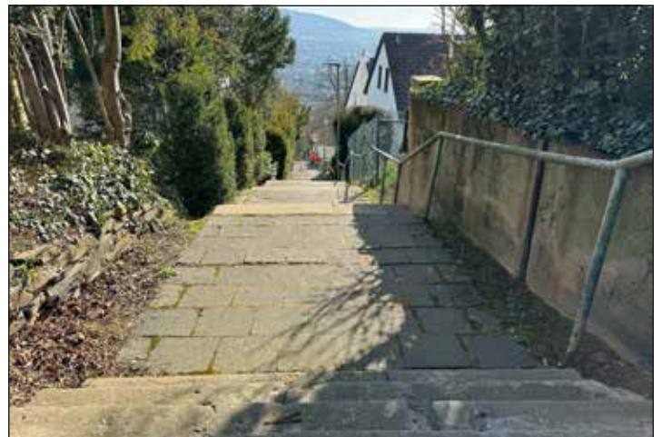
Schaden Treppenanlagen Am Spitzberg: Derzeit befinden sich die Treppen im Koblenzer Stadtteil Karthause in einem sehr schlechten Zustand und sind teilweise gesperrt. Foto: Stadt Koblenz/ Mandy Steffens
