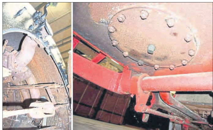
Korrosion ist ein großes Thema. Blick in die Rauchkammer mit Gegendruckbremse.
